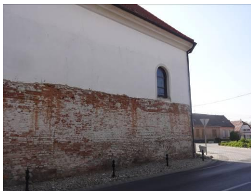
10. kép Homlokzati lefolyások
