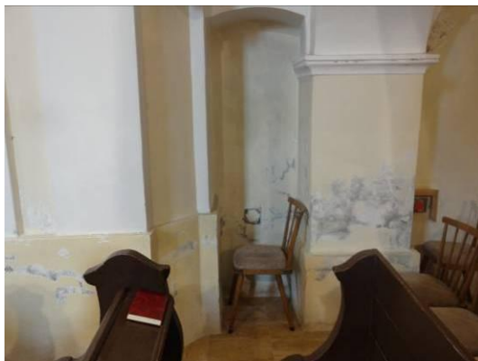
15. kép Károsodás a pilaszterek között
